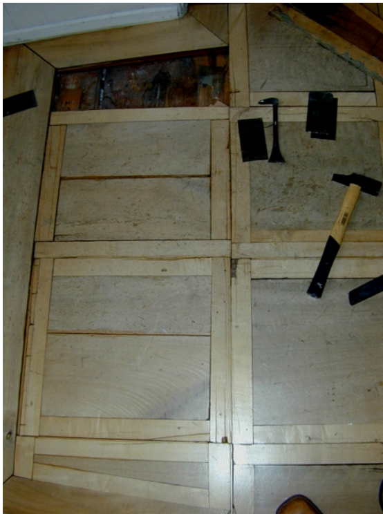
Abb. 3 Sondieröffnung Tafelparkett Oberfläche ist stark vergilbt, weisslich.
