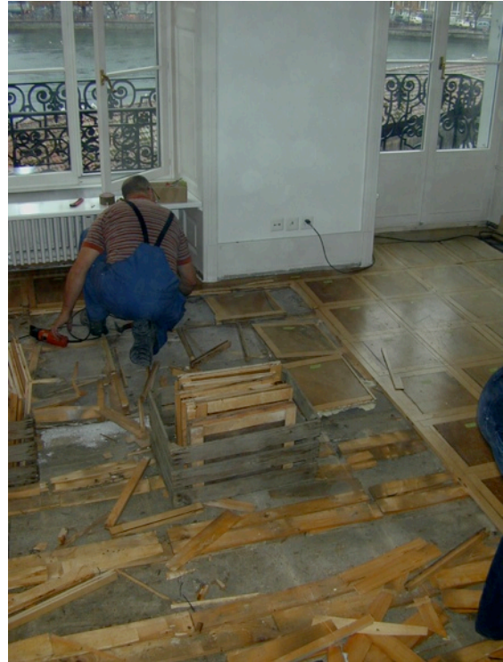
Abb. 4 Zwischenzustand bei Ausbau des Parkettes. Im Vordergrund die Schiftung zwischen Blindboden und Tafelparkett.
