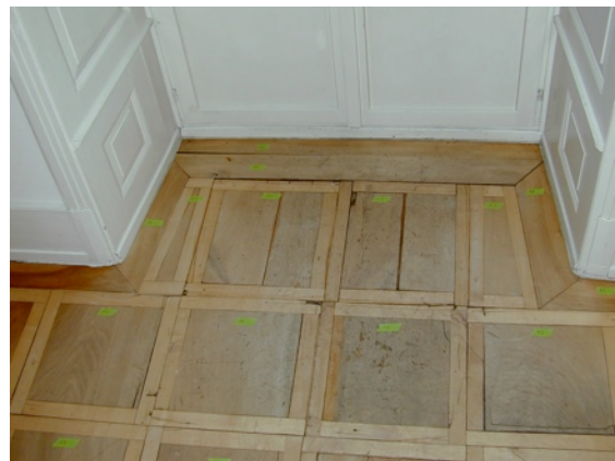
Abb. 2 Vorzustand Salon Tafelparkett mit erkennbaren Bauteilkonstruktionsrissen
