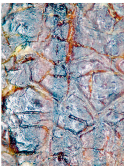
Abb. 5b: Darstellung der gealterten Architekturoberfläche. 60-fache Vergrößerung. Erkennbar sind die Frühschwundrisse mit Alterssprüngen im Beschichtungsaufbau des Bernsteinlackes.
