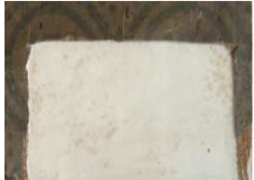
Abbildung 13: Linoleum-Schadstelle vor der Ergänzung
