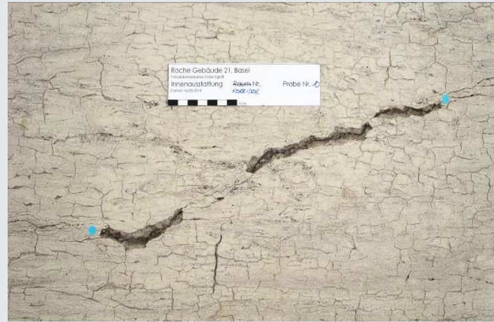
Abb.2 Zustandsaufnahme der Bauteildegradation (Foto Peter Egloff 2015)
