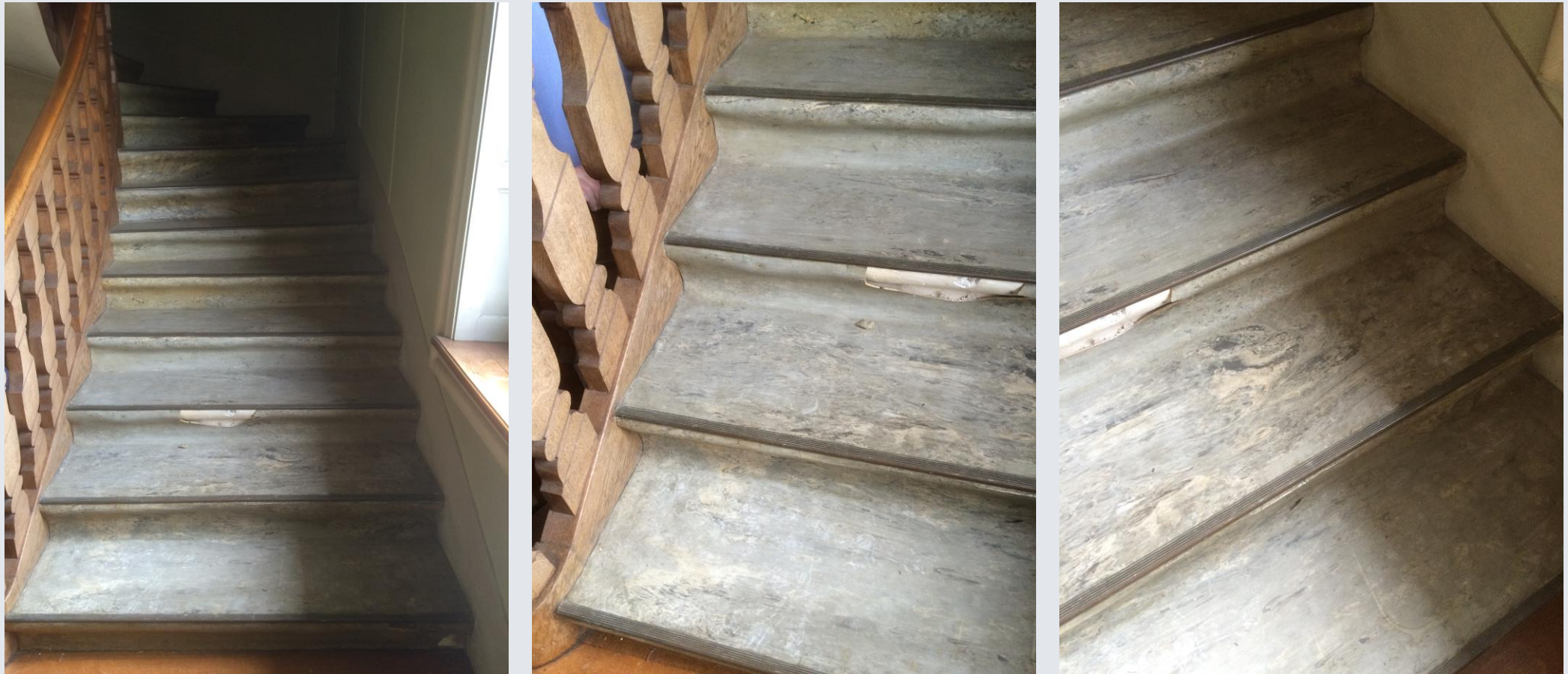
Abb. 1 – 3 Ansicht von Bodenflächen in Treppenhaus (Foto Peter Egloff 2016) Probenentnahme an Schadstelle / Farbe grau – weissliche Marmorierung
